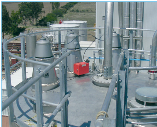
不锈钢模块化料箱通风装置
