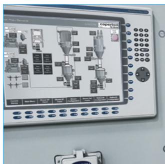
Controles basados en PLC
